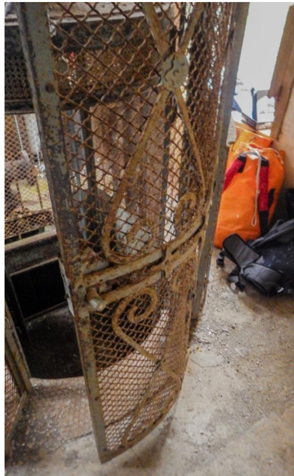
Foto 2 – L’ascensore sull’ingresso del pozzo
